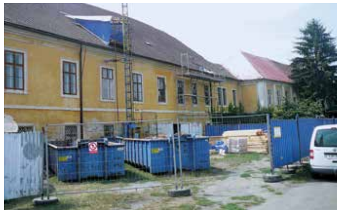
Firma STATUS započala v červenci práce na I. etapě oprav severovýchodního křídla školy.
